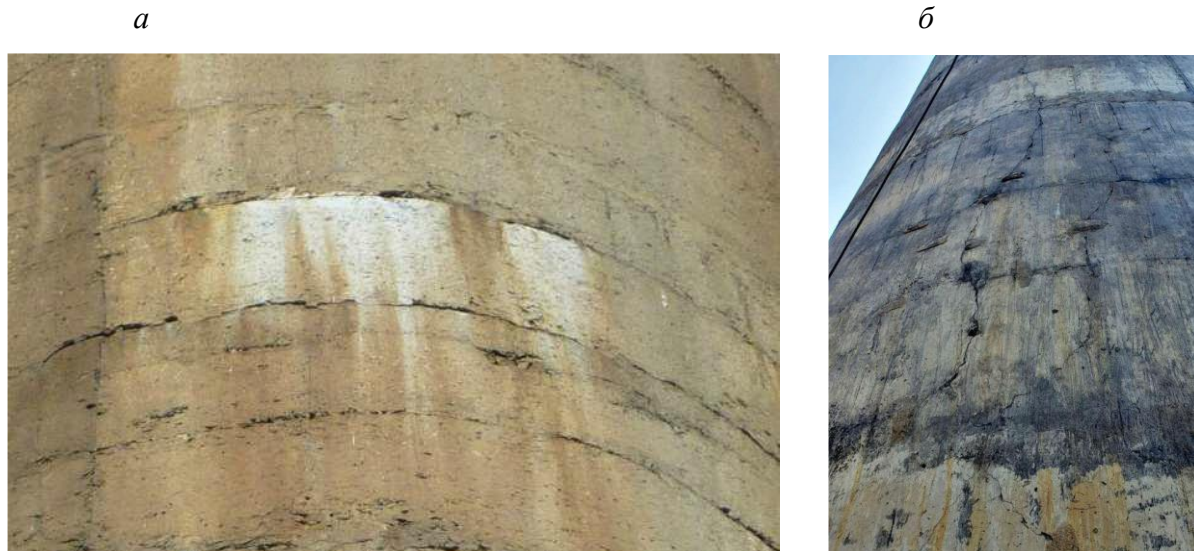
Рис. 2. Дефекти і пошкодження залізобетонної конструкції труби: а – раковини без оголення арматури, горизонтальні тріщини та висоли-пательки в місцях горизонтальних швів бетонування; б – вертикальні тріщини розкриттям понад 1 мм
