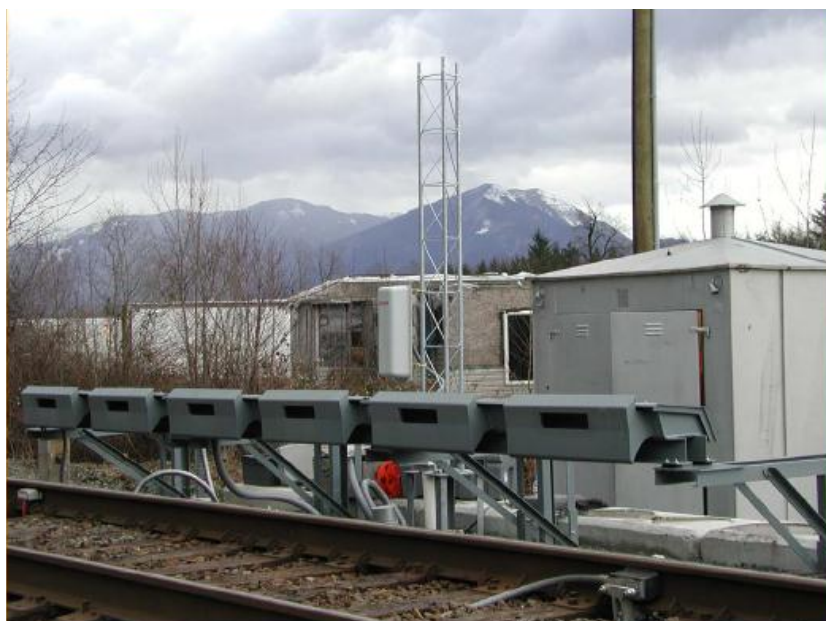
Рис. 2. Наземна система контролю шуму буксових вузлів (Acoustic Bearing Detector)
