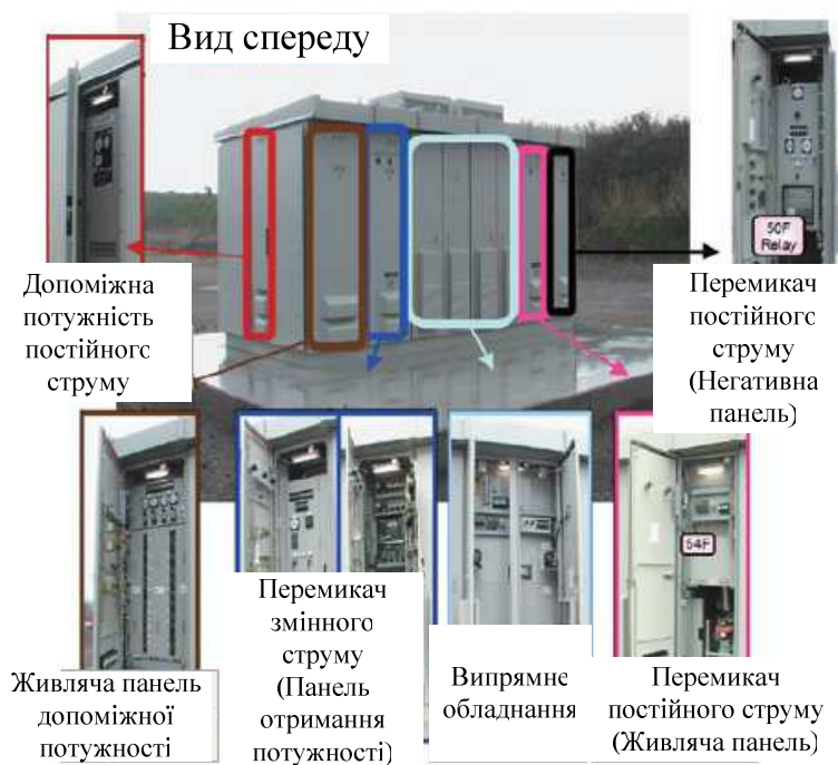
Рис. 2. Приклад тягової підстанції постійного струму комплектно-блочного типу
