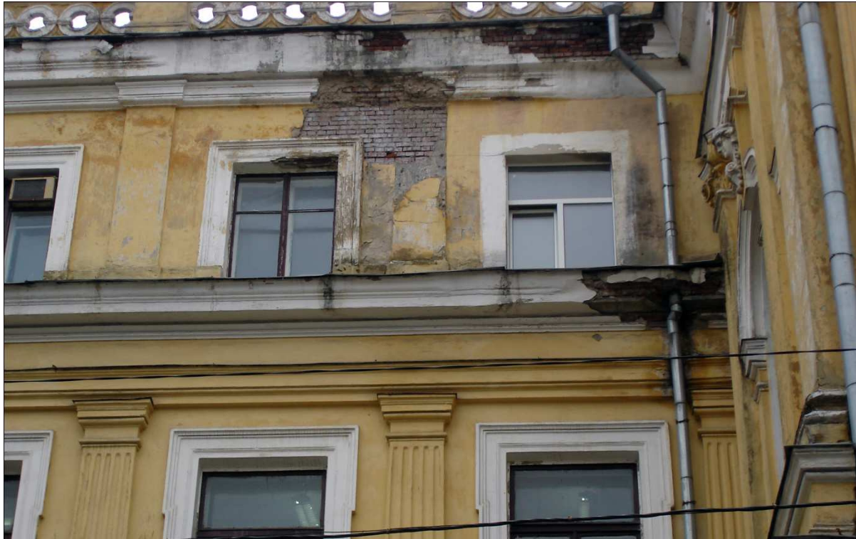
Рис. 1. Замачивание карниза и части стены в результате повреждения кровли
