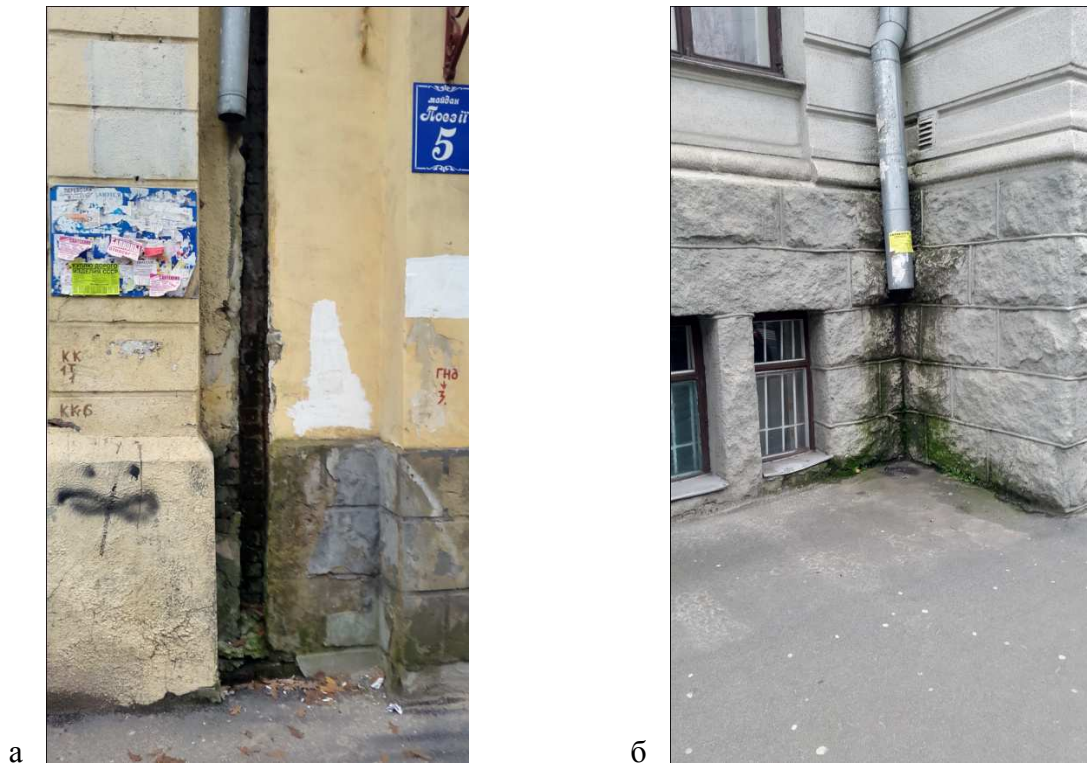
Рис. 2. Разрушение цокольной части здания в результате повреждения водосточных труб: а – на здании по адресу: ул. Поэзии 5; б – на здании института им. Мечникова
