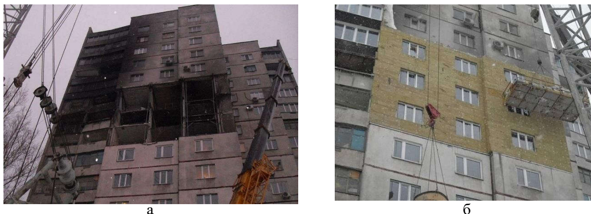
Рис. 13. Наслідки вибуху природного газу в шістнадцятиповерховому панельному будинку (а) і загальний вигляд відновленого фасаду (б)
