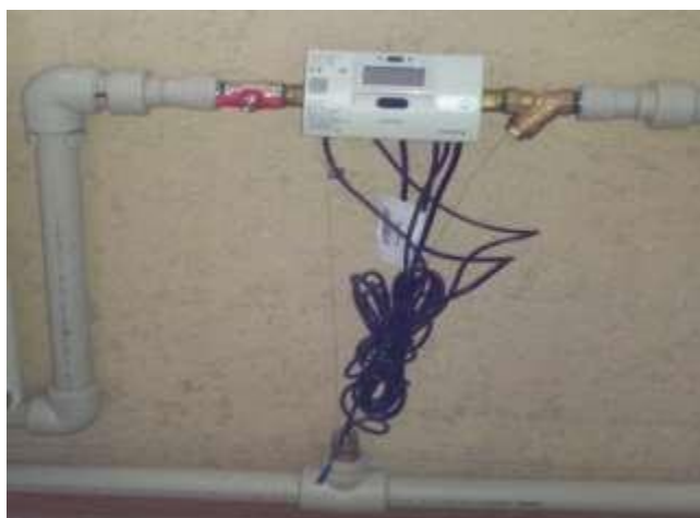
Рис. 4. Фрагмент установлення квартирної лічильника тепла
