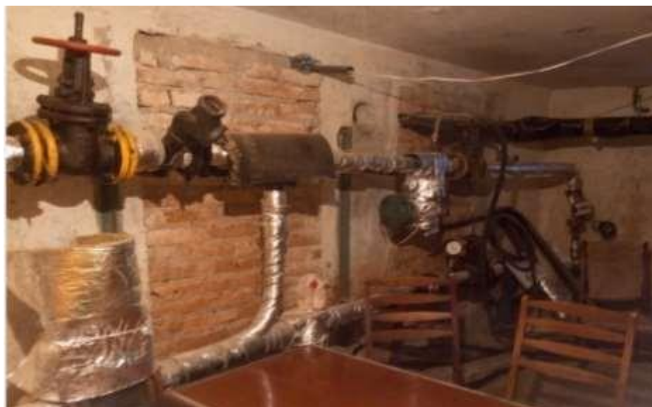
Рис. 6. Елеваторний вузол при залежному підключенні системи опалення житлового будинку до теплових мереж
