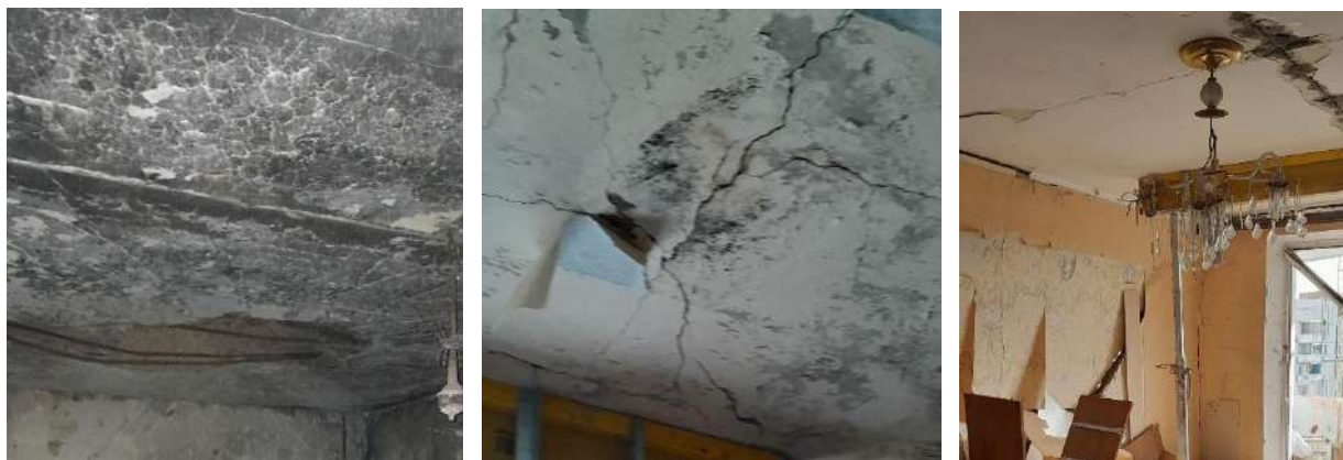
Рис. 6. Фотофіксація панелей перекриттів зі ступенем пошкодження 3
