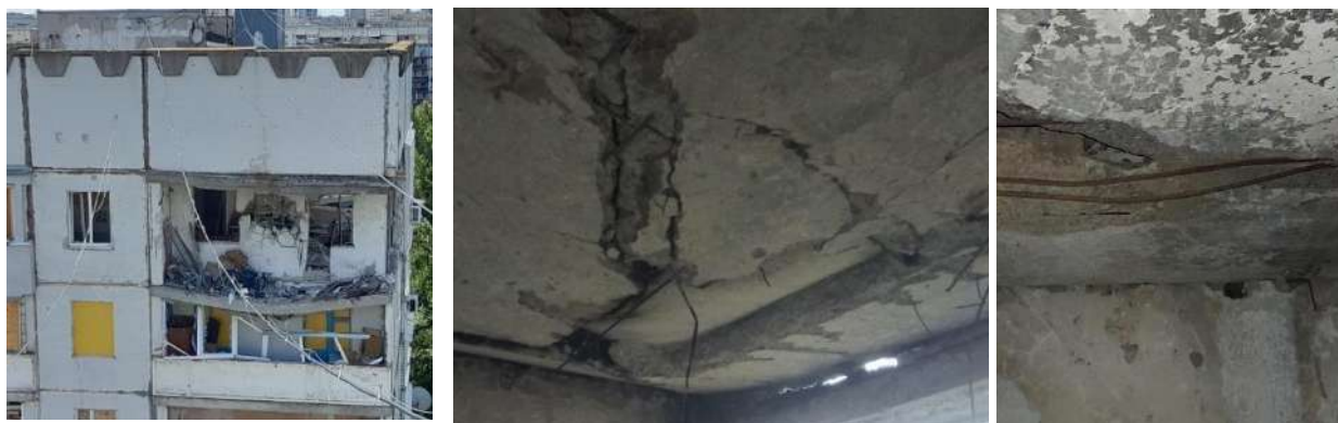
Рис. 7. Фотофіксація панелей перекриттів зі ступенем пошкодження 4
