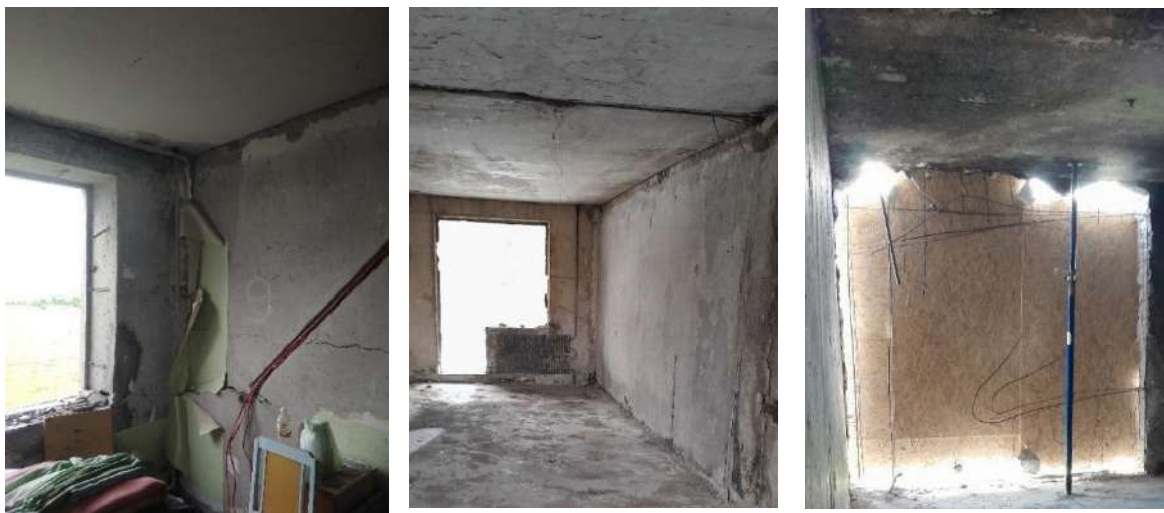
Рис. 4. Фотофіксація панелей перекриттів зі ступенем пошкодження 1
