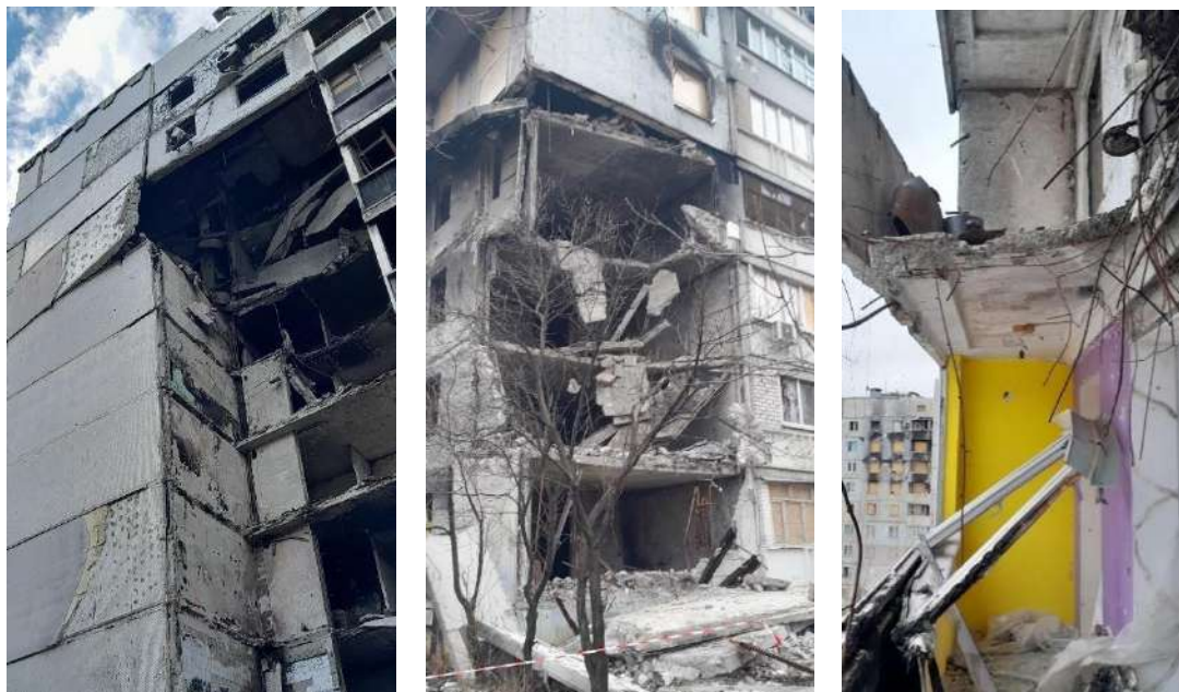
Рис. 8. Фотофіксація панелей перекриттів зі ступенем пошкодження 5
