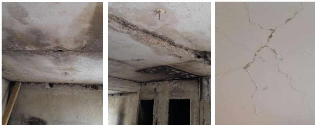
Рис. 5. Фотофіксація панелей перекриттів зі ступенем пошкодження 2
