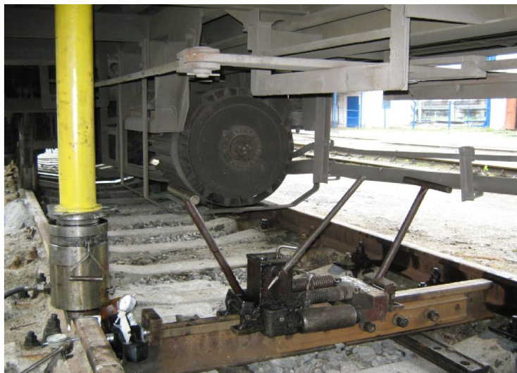
Рис. 1. Місце проведення експериментальних робіт із встановленим силовим гідравлічним обладнанням
