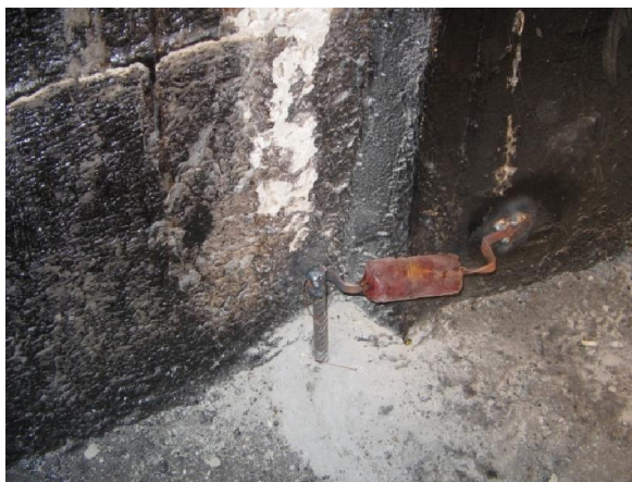
Рис. 10. Діодне заземлення металоін'єкційної сорочки бетонної опори пасажирської платформи: 1 – металоін'єкційна сорочка; 2 – діод Д231Б або Д232Б; 3 – заземлюючий стержень
