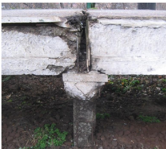
Рис. 3. Пошкодження (втрата суцільності) асфальтобетонного покриття і, як наслідок, пошкодження плит (а, б), ригеля та стояка (б) платформ з.п. Карачівка (а) і Жовтневий (б) дільниці Харків – Мерефа Південної залізниці
