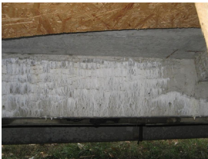
Рис. 4. Вилуговування на ребрі плити платформи з.п. Карачівка дільниці Харків – Мерефа Південної залізниці
