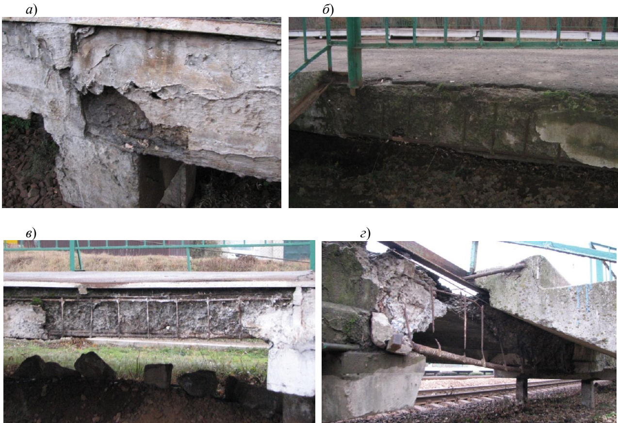
Рис. 5. Відшарування та відколи захисного шару ребер плит покриття пасажирських платформ з.п. Жовтневий (а, в), Покотилівка (б, г) дільниці Харків – Мерефа Південної залізниці: а – з оголенням і незначною корозією арматури; б – з оголенням і помітною корозією арматури; в – зі значною корозією робочої арматури з помітним зменшенням її перерізу, руйнуванням розподільчої арматури або втратою зв'язку робочої арматури з бетоном; г – з втратою зв'язку робочої арматури з бетоном і руйнуванням бетону стиснутої зони з помітним прогином плити
