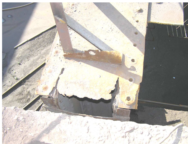
Рис. 6. Коррозионное разрушение узлового соединения опорного участка
