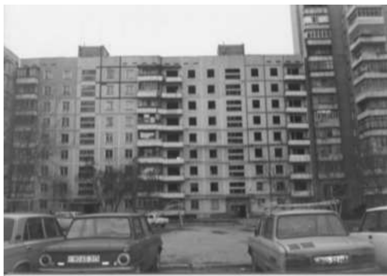
Рис. 1. Аварийное состояние блок-секции вследствие сталкивания смежных строений из-за встречных кренов по ул. Воронежской, ба в г. Запорожье
