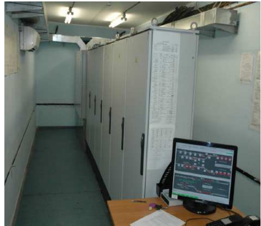
Рис. 3. Блокове приміщення МПЦ
